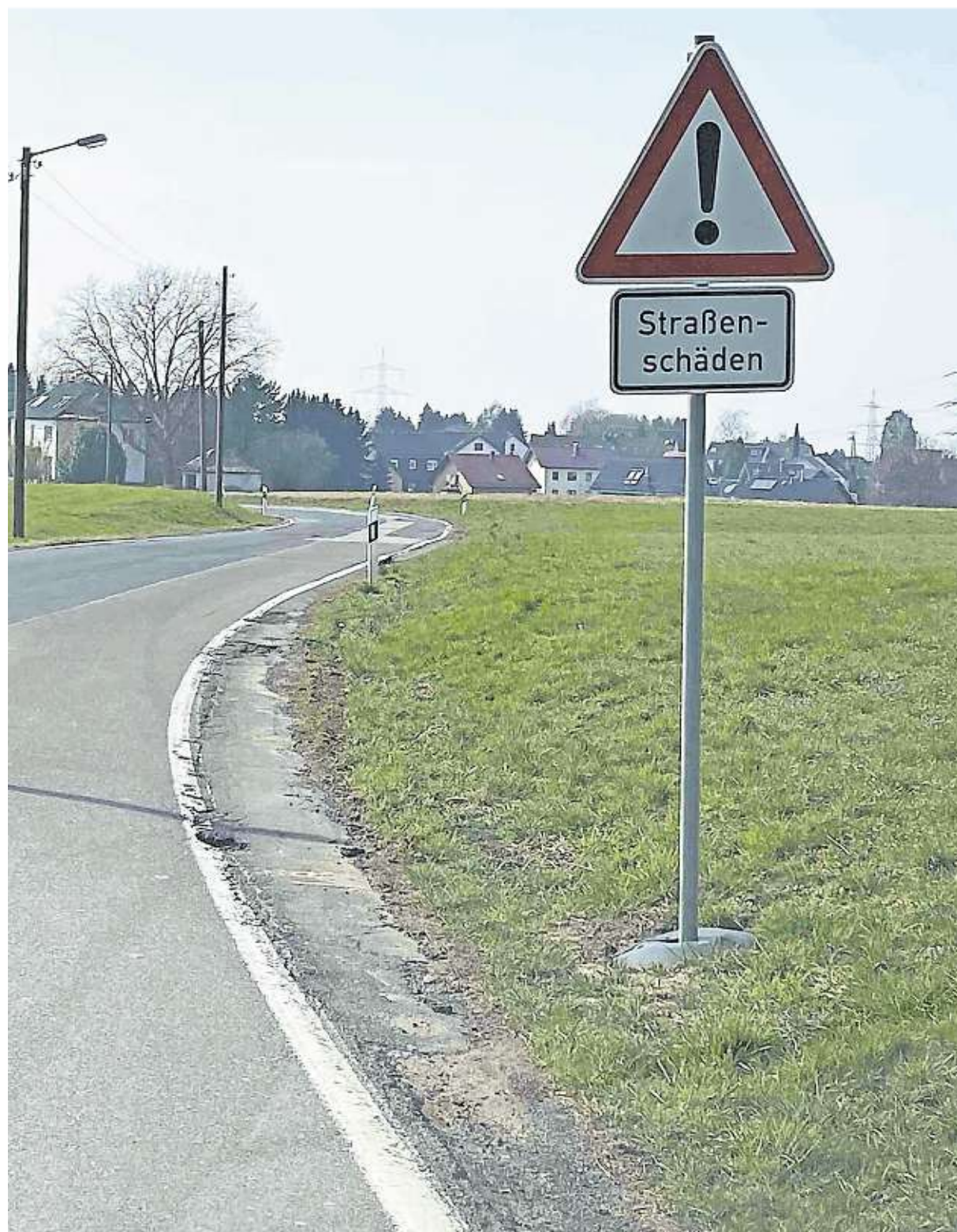
Die Landesstraße ist so schmal, dass Busse und Lastwagen in den Grünstreifen fahren müssen, um auszuweichen. Eine Gefahr für die Fußgänger am Straßenrand.
